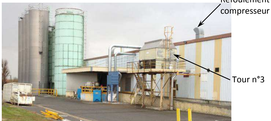
Tour aéroréfrigérante n°3
